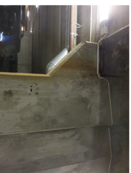
Bilde 9 Vegg langs rampen mellom K1 og K2 med høy fuktinnhold
