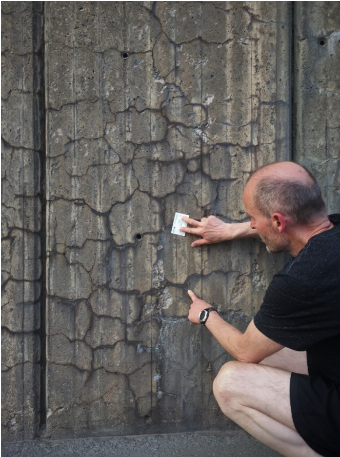
Jan Lindgård måler rissvidder på en støttevegg i Oslo
