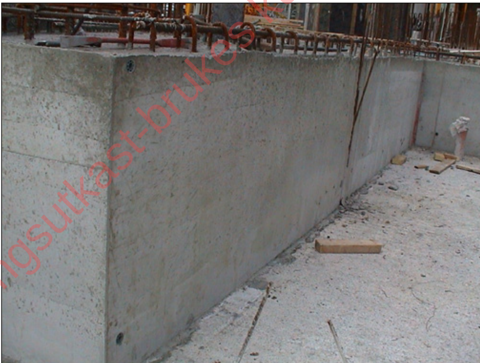
Figur 3.9 Synlig sjiktdannelse pga tiksotropisk tilstivning. Bunnplaten, Rica Seilet Hotel, Molde
