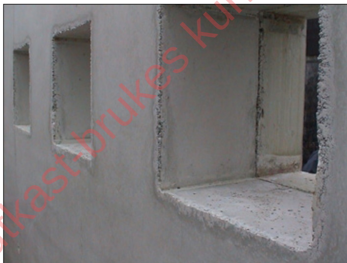
Figur 3.6. Sår pga. lekkasje i formen, Levanger sykehus.
