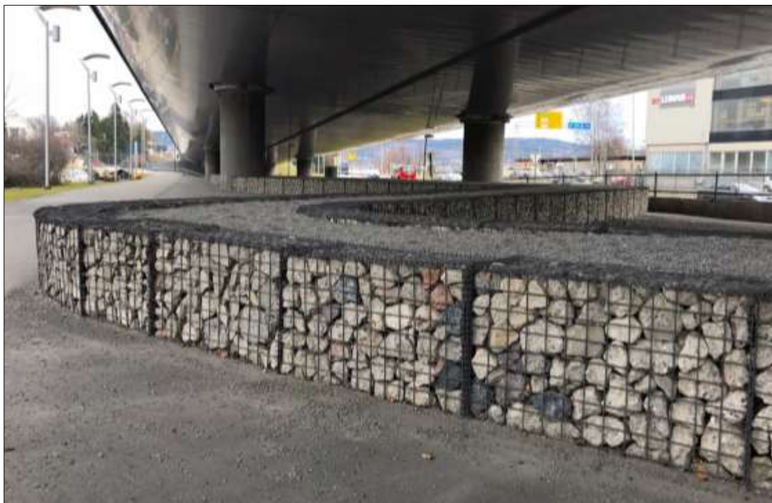
Figur 16 Gabioner fylt med knust betong kan være en nyttig måte å utnytte rivningsbetong på. De kan for eksempel brukes til å lage støttemurer. En annen positiv miljøeffekt er at den knuste betongen vil oppta CO 2 fra atmosfæren gjennom økt karbonatisering. Foto: Betongfokus
