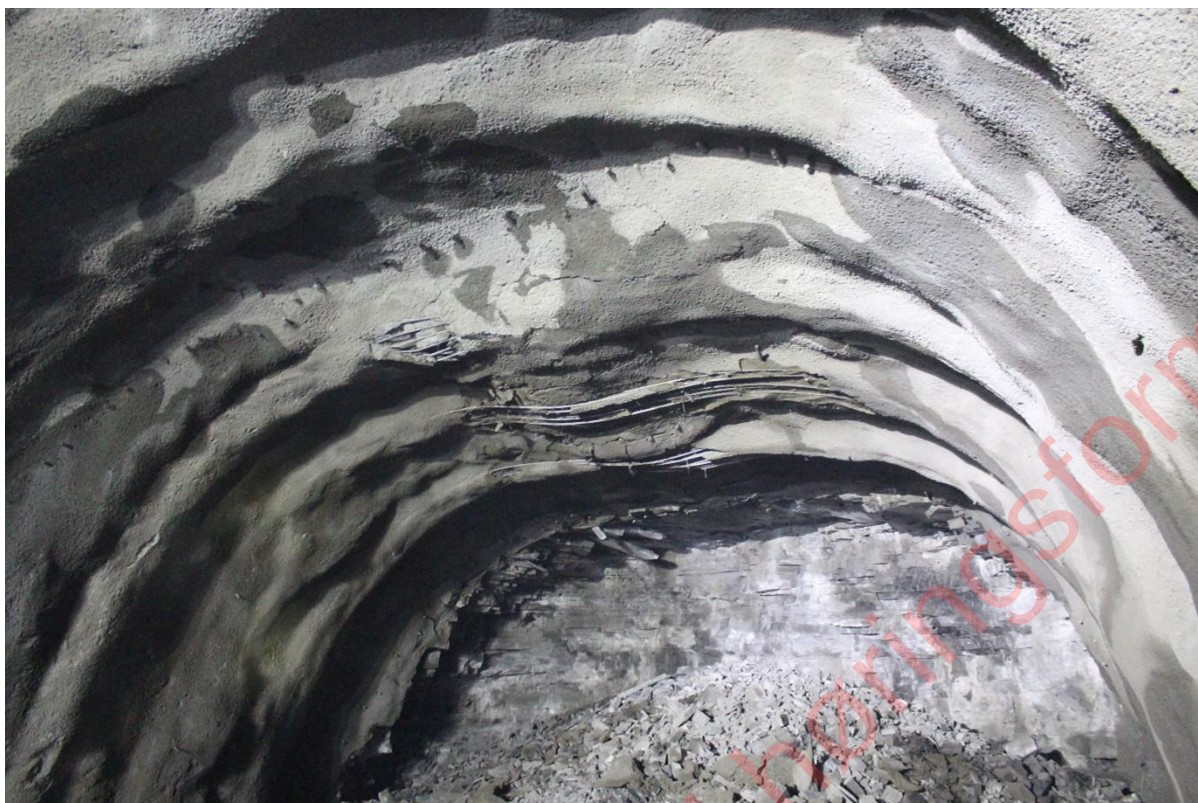
Figur 3-12: Effekt av bergtrykk i kombinasjon med tett oppsprekking. Betydelig deformasjoner og sprekke dannelse i armerte sikringsbuer og innstøpte bolter montert på stoff, forårsaket av bergspenningskonsentrasjoner og ugunstig subhorisontal sprekkeorientering. Deformasjonene nådde maksimum omfang ca. 8-10 m bak stoff ved driving av en tunnel med spenn ca. 13 m. Foto: Skanska Norge AS.
