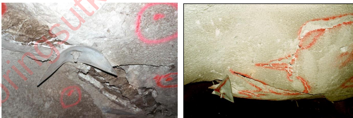
Figur 3-10: Effekter av høyt bergtrykk. Sprekkedannelse i stålfiberarmert sprøytebetong og deformerte bergbolter. Fra drivingen av Lærdalstunnelen. Foto: Eystein Grimstad.
