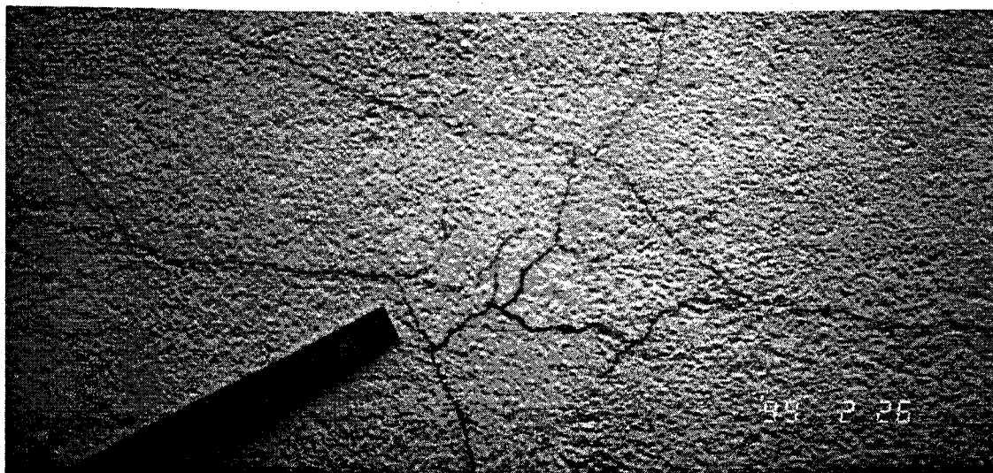
Fig.5.1 Riss i overflatebehandlingen
