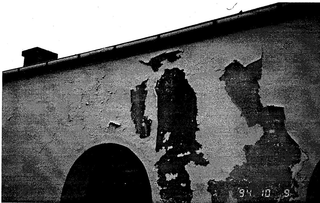
Fig. 1.2 Fasade med avflassingsskader etter kort tid
