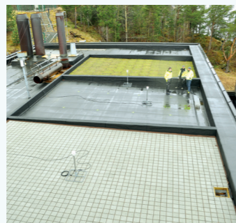
Testanlegget på Høvringen rensaneanlegg i Trondheim. Foto: Tore Kvande, NTNU.
