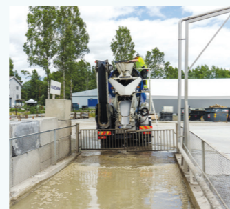
VASKEANLEGG. Fabrikken på Hamar bruker som mange andre fabrikker i Norge, et vaskeanlegg for å ivareta vaskevann fra automikser og blandeanlegget.
