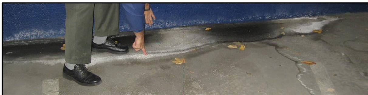
Figur 2.16 Byggeår ca. 1973–fra prosjekt som fig 2.7 Overhøyde for hulldekker gir dammer i kritiske oppleggssoner.
