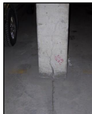
Figur 2.12 Byggeår ca. 1973 – fra prosjekt som fig 2.7 Søyle binder sammen to "uavhengige" enheter og rives fra hverandre over fuge.
