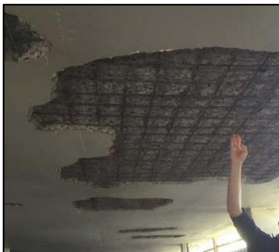
Figur 2.5 Byggeår 1976 - Klorider trukket gjennom hele dekket.
