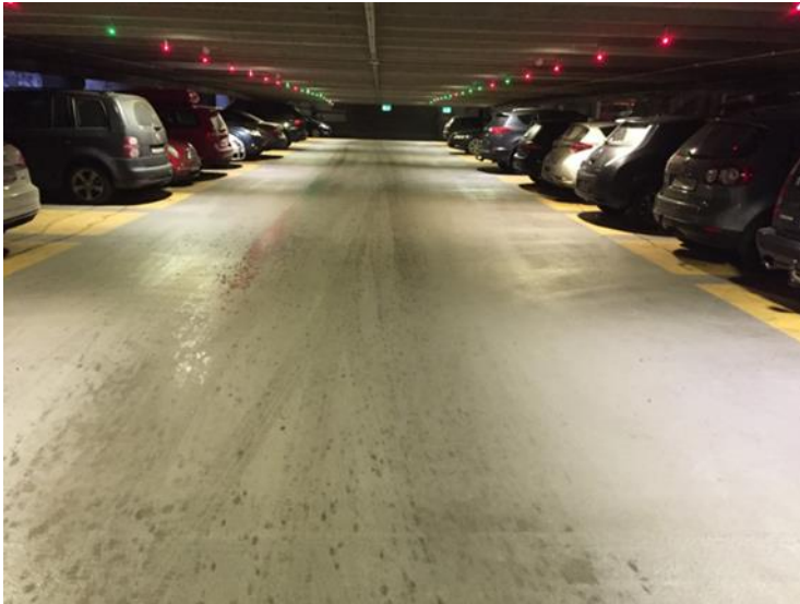
Figur 3.4: Belegg rett på DT-elementer der det ikke er riss og sprekker mellom enkeltelementer.
