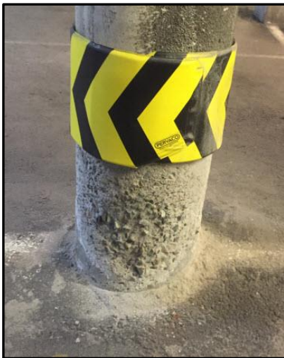
Figur 2.19 Byggeår 1985 Søylebunn nær innkjøring i fuktig miljø / vannlekkasjer / salt / frost.
