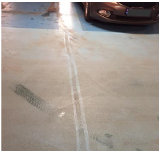
Figur 3.3: Belegg direkte på hulldekker med riss i belegg over fuge mellom elementene.
