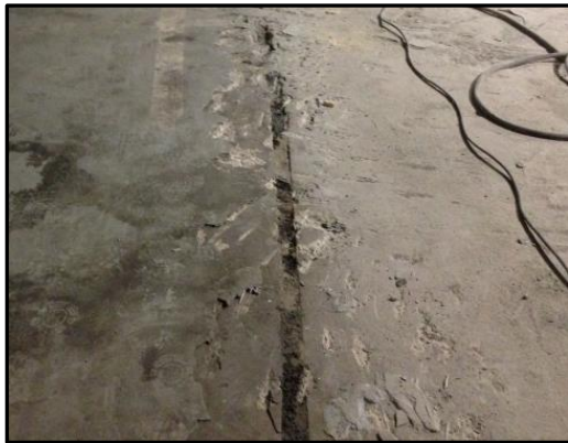
Figur 2.23 Avskalling / bom svak utførelse mot fuge.
