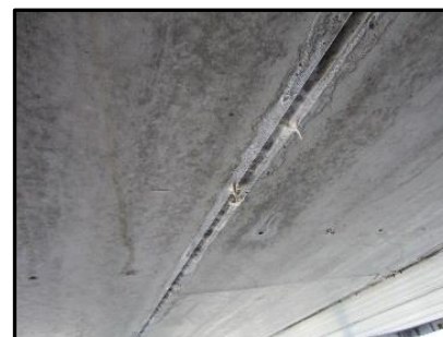
Figur 2.14 Byggeår ca. 1985 Lekkasjer mellom elementer og ned til hull i hulldekker.
