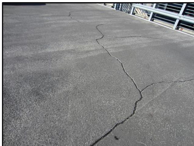
Figur 2.25 Støpeasfalt er mye brukt som slitasje og tettemateriale, men eksponert for UV-stråling / sollys vil svinne og sprekke. Alle overflater eksponert for sollys må være UV-bestandig.
