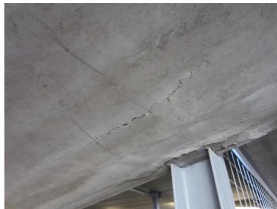
Figur 2.21 Byggeår ca. 1985 – Uheldig "opplegg" hvor det skal være bevegelsesmulighet for hulldekke.
