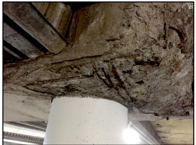
Figur 2.20 Byggeår 1985 Kapitel nær innkjøring i fuktig miljø / vannlekkasjer / salt / frost.
