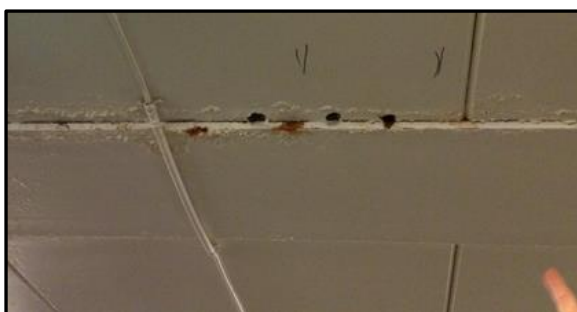
Figur 2.13 Byggeår ca. 1985 HSQ-bjelke som opplegg for hulldekker. Over er det lavbrekk og utettheter.
